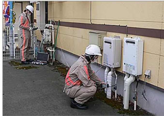
LPガス設備の安全点検にてライフラインを確保
