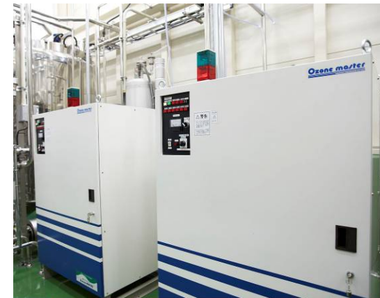
<③オゾン水製造装置>
