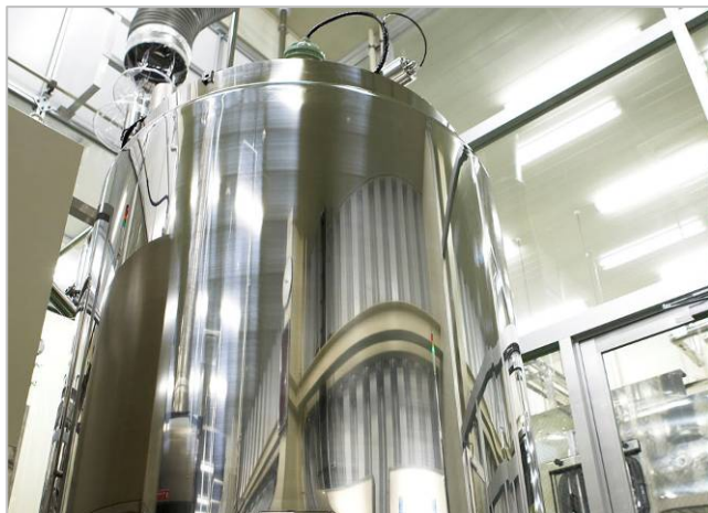
<④サージタンク(1トン)>
